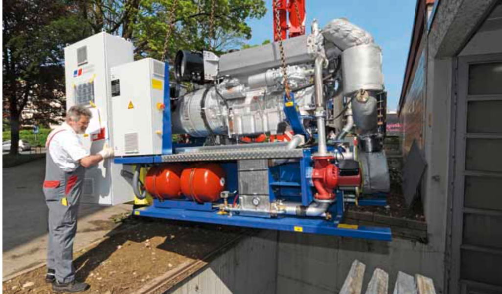
Gewichtiger Baustein für eine effiziente Nahwärmeversorgung: Das neue Blockheizkraftwerk.
